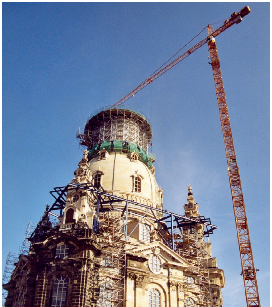
Bauarbeiten an der Dresdner Frauenkirche im Jahre 2004, kurz vor der Fertigstellung Bild: m4thias/iStock
