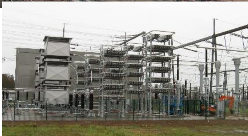
Kompensationskondensator (Umspannwerk Engstlatt)
